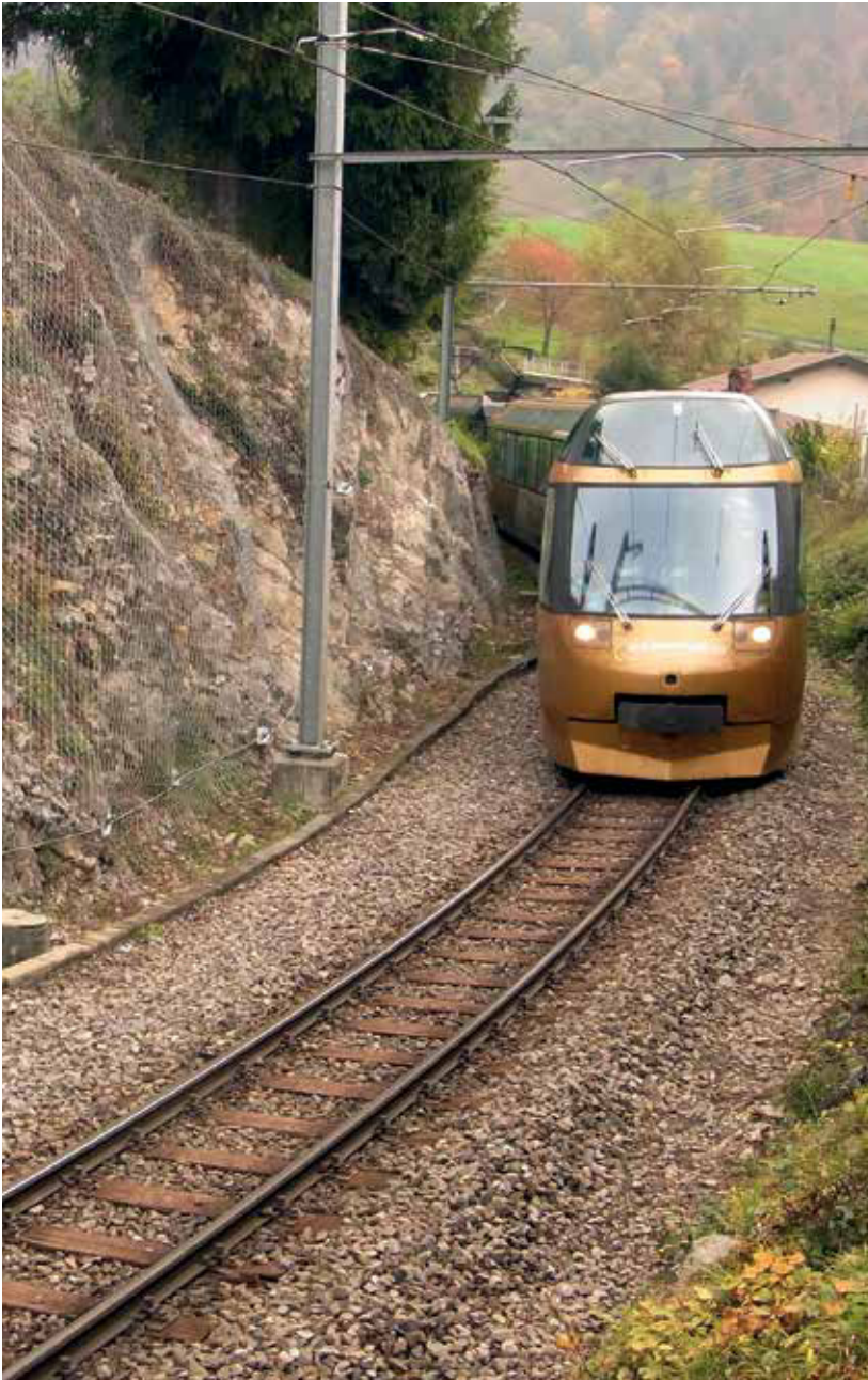
Assainissement de la falaise de Sonzier : pose de 850m 2 de treillis métallique
